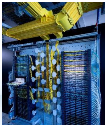
PRIME ODF Répartiteur optique haute capacité
