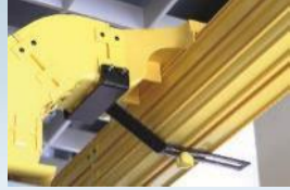
Chemins de câbles
